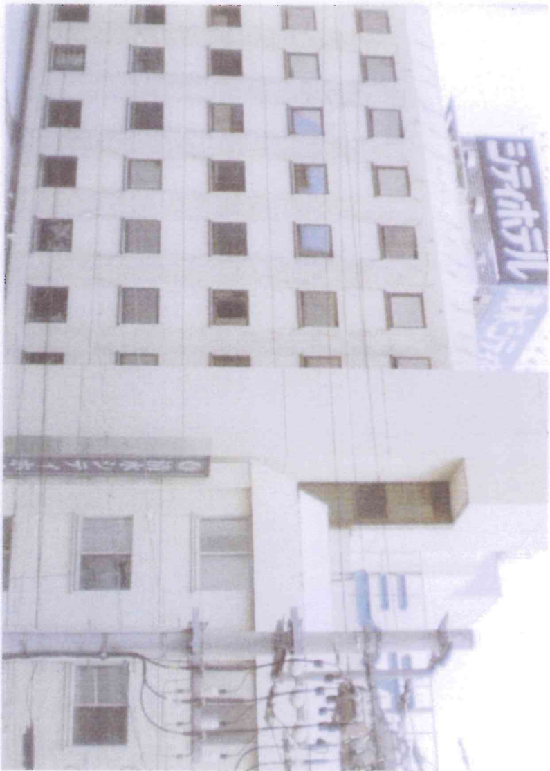
清水シティホテル/2007年/静岡県/ホテル改修工事(タイル劣化)
