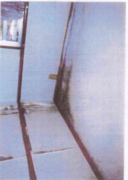
隅角部の結露とかび発生
